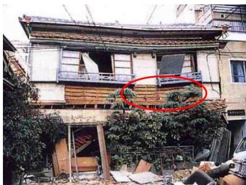
下地材の破損 (程度Ⅴ)
