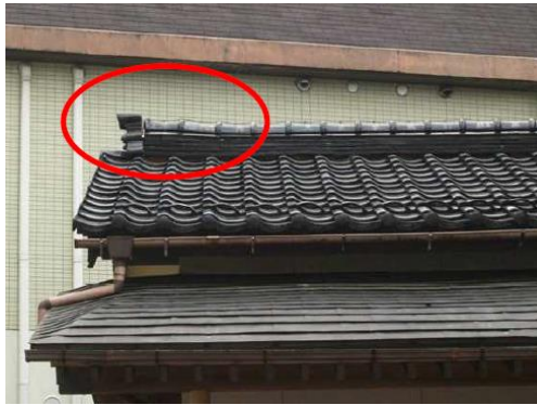
棟瓦の一部にずれ等 (程度Ⅰ)
