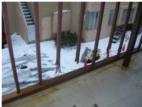
バルコニーの手すりが腐食している
