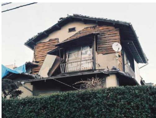
下地材のひび割れ (程度Ⅳ)
