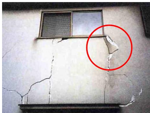
仕上げの剥離 (程度Ⅱ)
