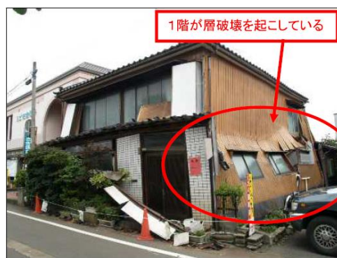
1階部分が層状に破壊している
