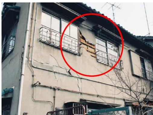
仕上の脱落 (程度Ⅲ)
