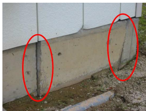
基礎が破断している
