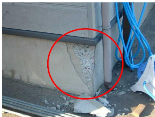
基礎が剥落している
