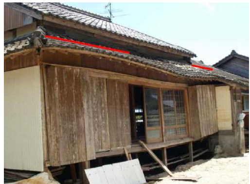
屋根に若干の不陸 (程度Ⅳ)
