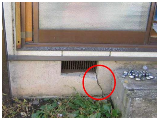
基礎がひび割れている
