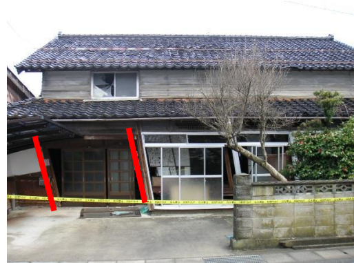
1階部分が傾斜している
