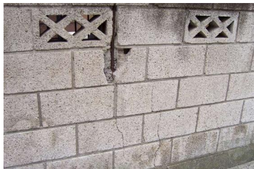
塀に大きなひび割れが生じている
