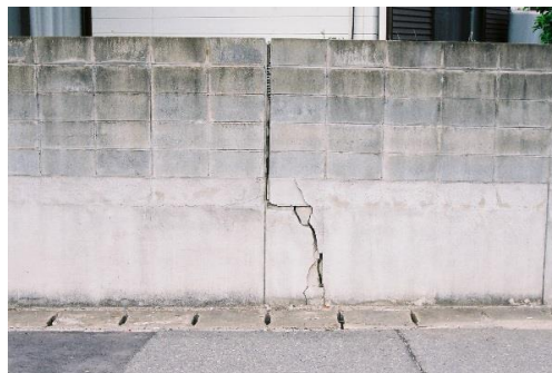
塀に大きなひび割れが生じている
