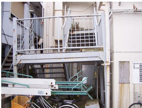
屋外階段が傾斜している
