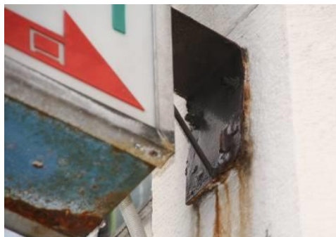
支持部分に著しい腐食が発生している
