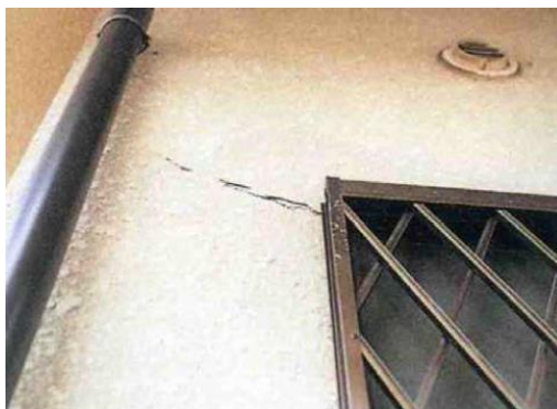
開口部廻りのわずかなひび割れ (程度Ⅰ)
