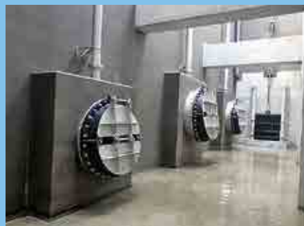
雨水ポンプ用逆止弁
