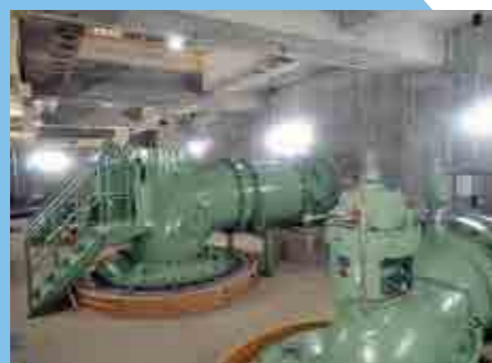
No.1,2,3雨水ポンプ
