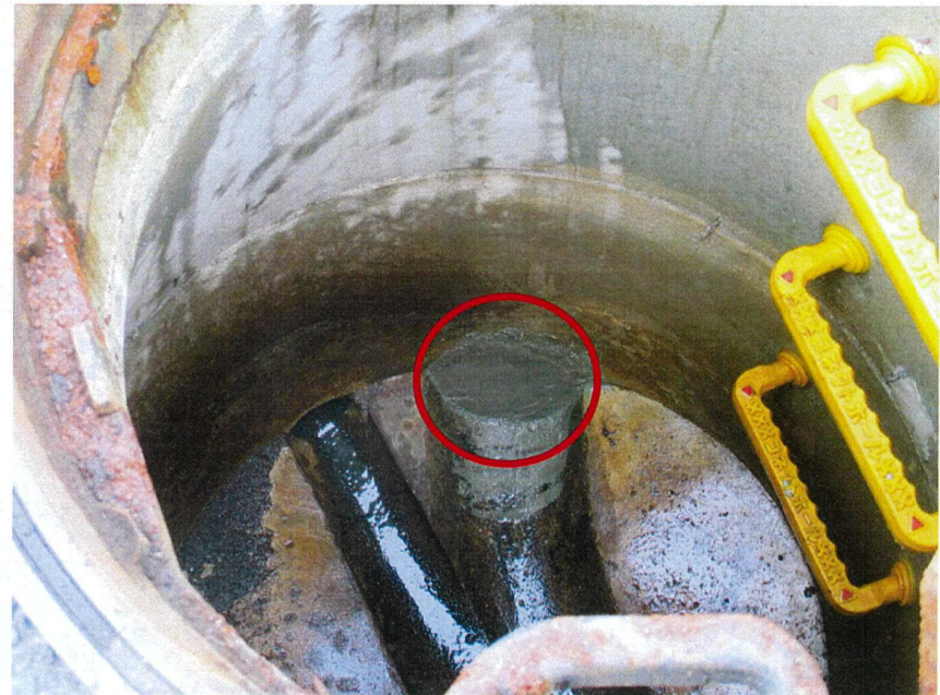
マンホール内閉塞状況
