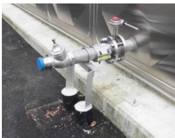
打上配水池内緊急給水栓
