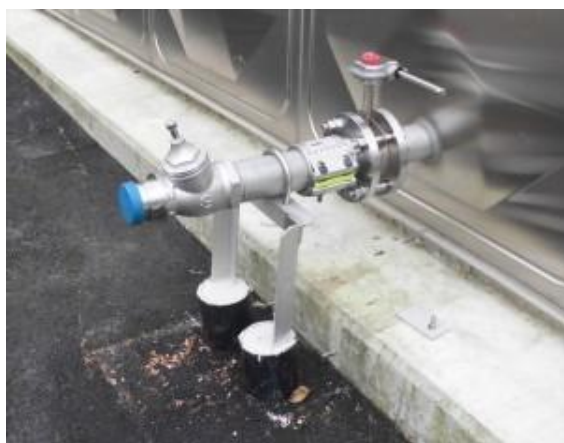
写真 打上配水池内緊急給水栓
