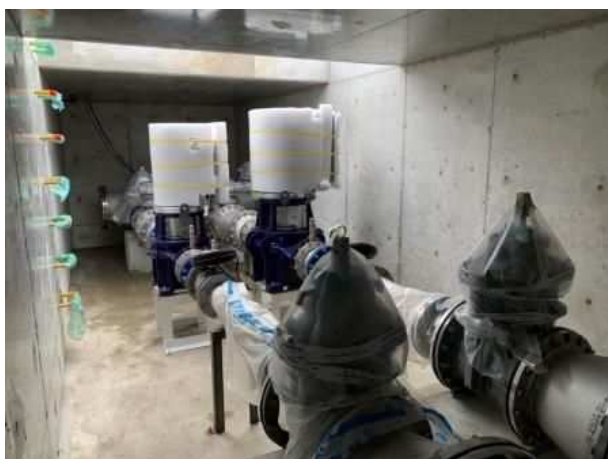
楠根配水場のマイクロ水力発電
