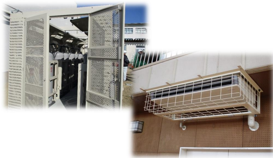
災害時にプロパンガスに切り替えができるエアコン
