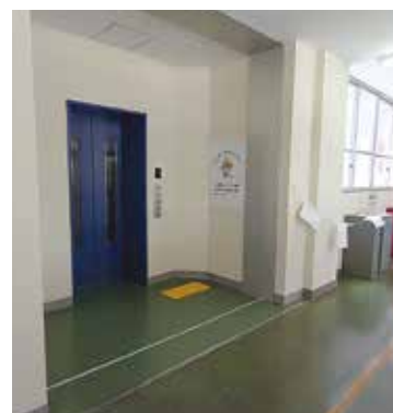
設置されたエレベーター
