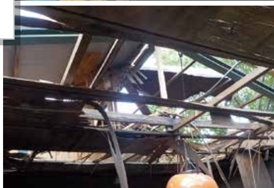
家屋被害の様子
