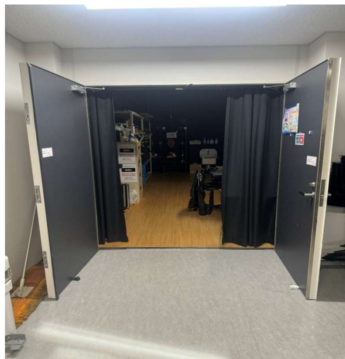
【機材室防火扉】
