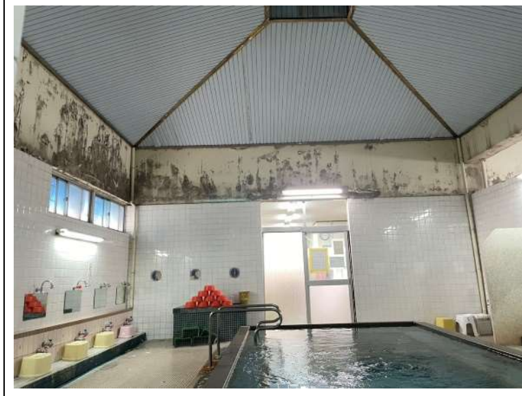
【老朽化による壁の剥離】
