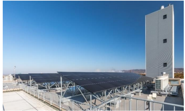
図 1-13 クリーンセンター屋上の太陽光パネル
