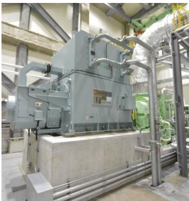
図 1-14 ごみ発電(蒸気タービン発電機)
