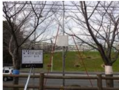
盤、単管パイプ、支線
