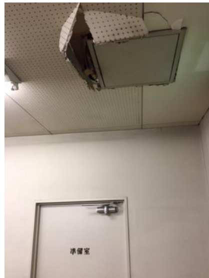
(右：4階の天井のはがれ)
