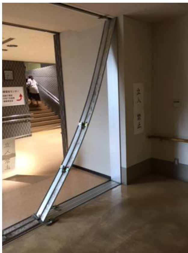
（総合センターと保健福祉センターをつなぐ 連絡通路のエキスパンジョイント部が落下）
