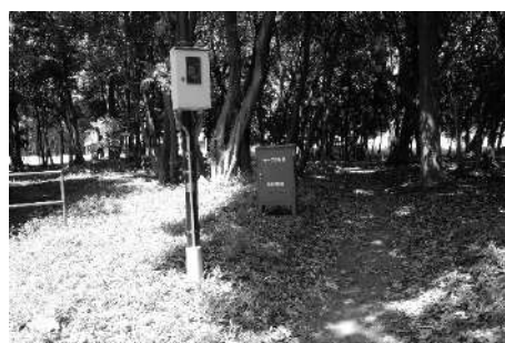
写真 46 社殿東側の消火栓（南から）
