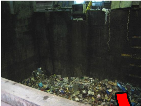
【通常の不燃ごみピット】
